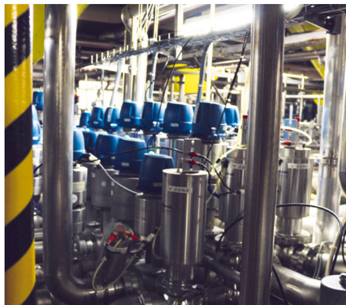
Mit Druckluft werden in der Brauerei auch Ventilinseln angesteuert.
