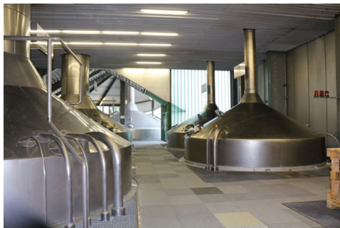
Im Sudhaus wird mit Druckluft zum Beispiel die Würze belüftet.
