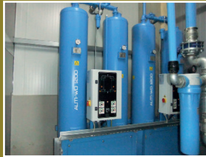
04 Die Adsorptionstrockner ALM-WD 1200 von Almig sorgen dafür, dass die Druckluft auf den Drucktaupunkt von minus 40 °C getrocknet werden kann
