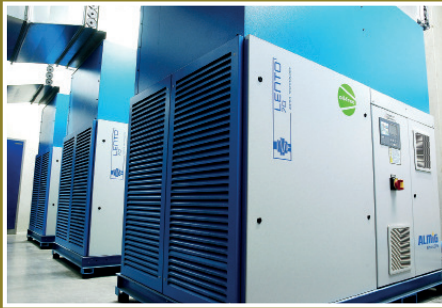
03 Die Lento-Anlagen weisen deutlich geringere Wartungskosten im Vergleich zu alternativen Technologien auf
