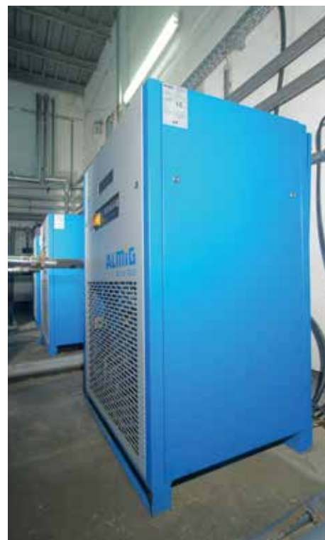
Bild 6. Die von den Kompressoren erzeugte Druckluft wird in Kältetrocknern mit einem Drucktaupunkt von 3°C getrocknet
