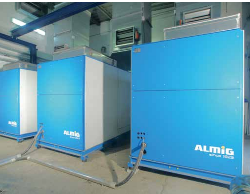
Bild 5. Druckluft-Station mit drei drehzahleregelten Schraubenkompressoren mit Öleinspritzkühlung und integrierter Wärmerückgewinnung
