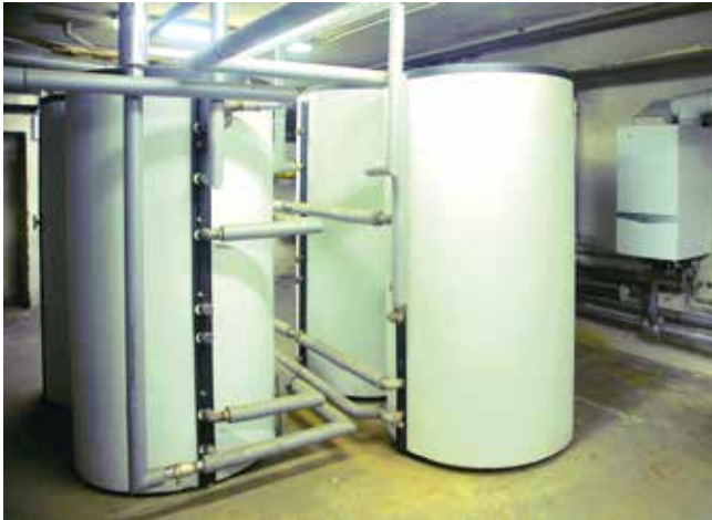
Bild 2. Die anfallende Abwärme wird über einen geschlossenen Wasserkreislauf an zwei Speicherbehälter mit einem Gesamtvolumen von 6000 Liter weitergegeben
