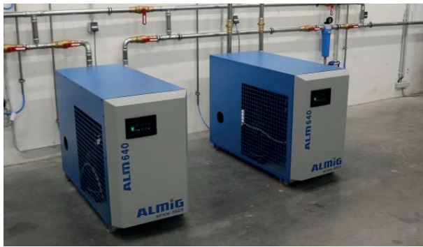
Die externen Kältetrockner: Ihre Kennwerte sind an die jeweilige Anlage exakt angepasst.
