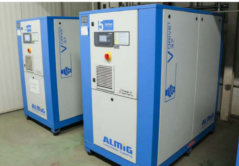
Um auf den wechselnden Druckluftbedarf reagieren zu können, kommen drehzahlgeregelte Schraubenkompressoren von ALMiG zum Einsatz.
