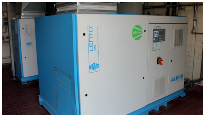
Bad Meinberger setzt auf ölfreie wassereingespritzte Schraubenkompressoren der LENTO-Baureihe von ALMiG.
