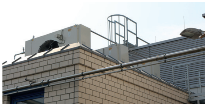
Die drei Wasserkühler für jeden Kompressor sind auf dem Dach angebracht. In einem geschlossenen Kühlkreislauf werden die Maschinen mit Wasser versorgt.
