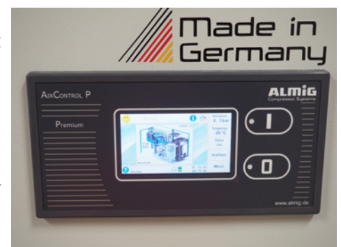
Die Steuerung ALMiG Air Control P regelt die Kompressoren im Verbund. Damit lassen sich die Energievorteile der Drehzahlregelung voll nutzen.
