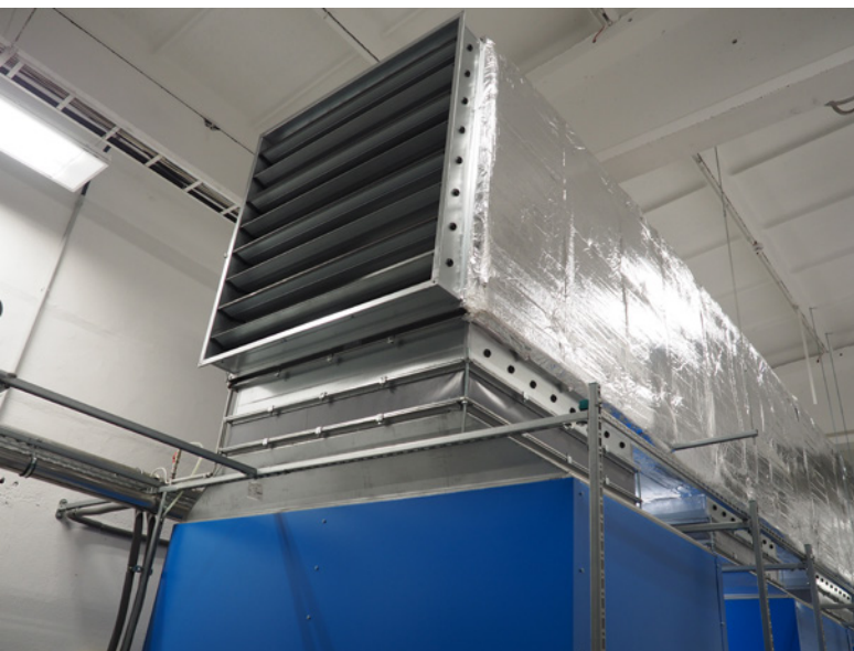
Die Wärme der Kompressoren nutzt das Unternehmen, um sein Lager im Winter zu heizen.
