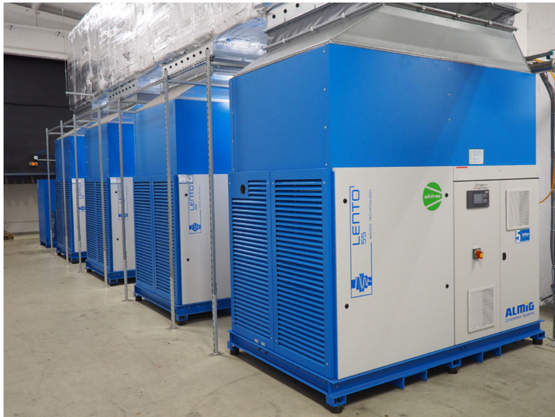
B. Braun Avitum Saxonia setzt in der Produktion auf ölfreie, wassereingespritzte Schraubenkompressoren von ALMiG.
