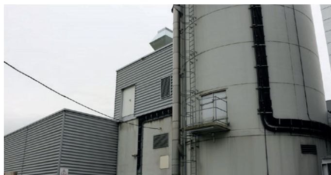
Für die neuen Kompressoren hat Moser einen neuen Technikraum gebaut (in der Mitte oben). Bei der Montage wurden die Anlagen über das Dach eingelassen.
