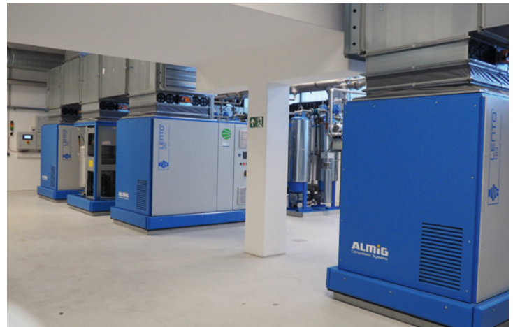
Garantiert nicht von der Stange: Die Druckluftstation von ALMiG erfüllt ganz besondere Anforderungen an eine saubere Druckluft.
