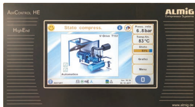
Die ALMiG Air Control HE steuert die Kompressoren verbrauchsabhängig im Verbund. Damit lassen sich die Energievorteile der Drehzahlregelung voll nutzen.
