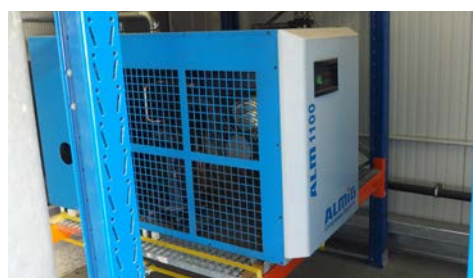
Der externe, Kältetrockner: Seine Kennwerte sind an die jeweilige Anlage exakt angepasst.
